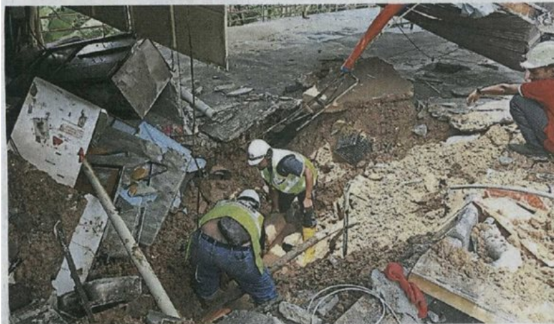
▲地陷情况严重，所幸无人伤亡。
