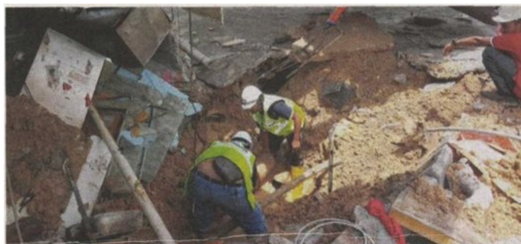
BEBERAPA pekerja Syabas membaik pulih paip pecah akibat tanah mendap di sebuah kedai makan di Jalan Saga 29, Taman Saga, Ampang Jaya semalam.
